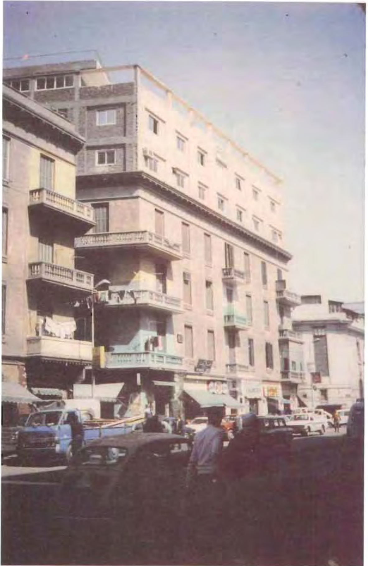
التشوية المعماري بإضافة طوابق علوية دون مراعاة لطرز المبنى الأصلي.
